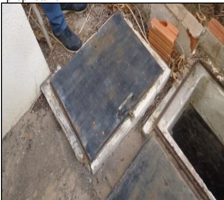
Foto nº 32 Tampas de acesso a cisterna em chapa de ferro, em processo de corrosão com risco de contaminação, fora de norma.
