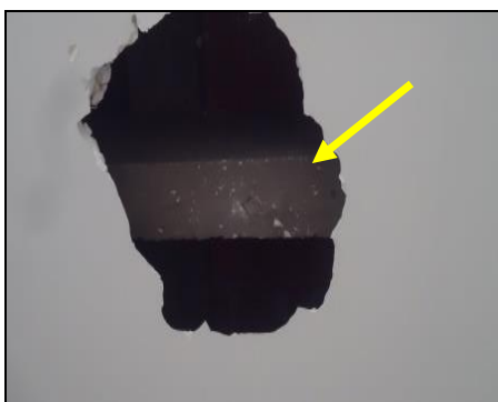
Foto nº 27 Viga engastada diretamente na alvenaria.
