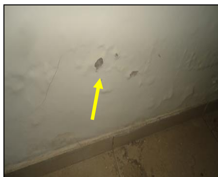
Foto nº 28 Revestimento de parede apresentando marcas de umidade vinda do solo por capilaridade, por falta de impermeabilização dos elementos de fundação.
